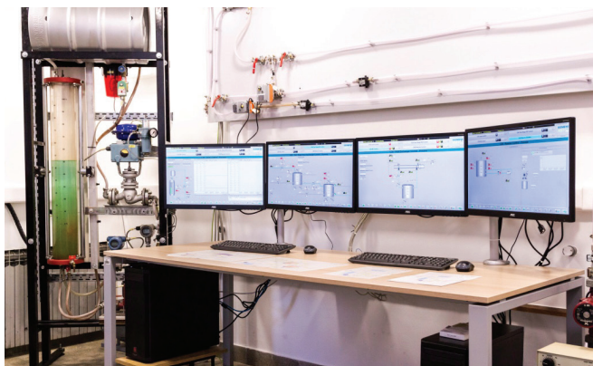
Slika 3 – SCADA sustav s operatorskim sučeljem (operatorska sala)
